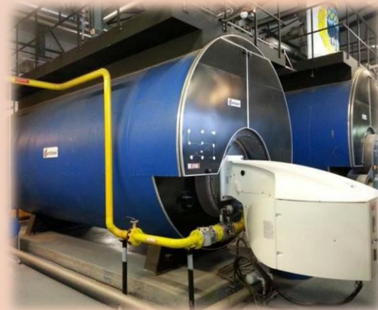
Паровые котлы 8 МВт
