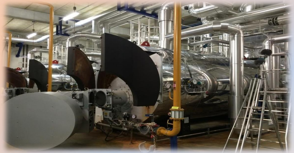
Промышленный котел 18МВт
