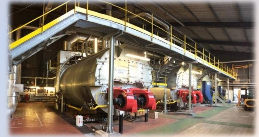
Городское отопление 14 МВт
