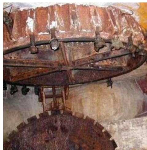
нижняя крышка выпарной установки
