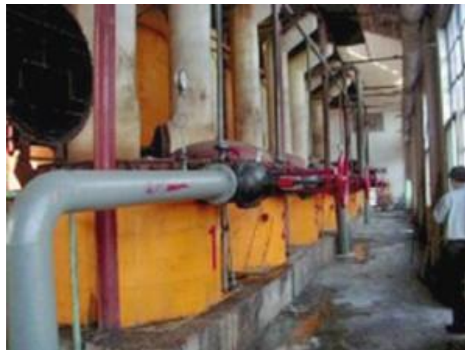
Верхняя часть выпарных установок (этажом выше)
