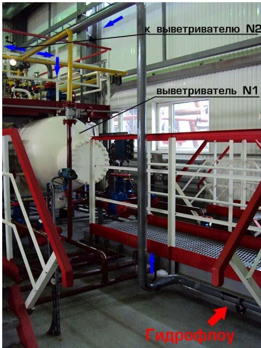
Защита от накипи выветривателей газа. Лукойл. Западная Сибирь.
