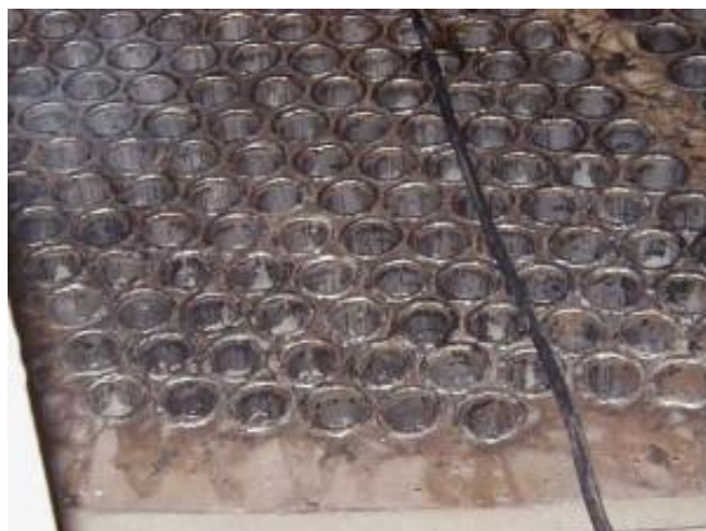
Трубный пучок после запуска Гидрофлоу
