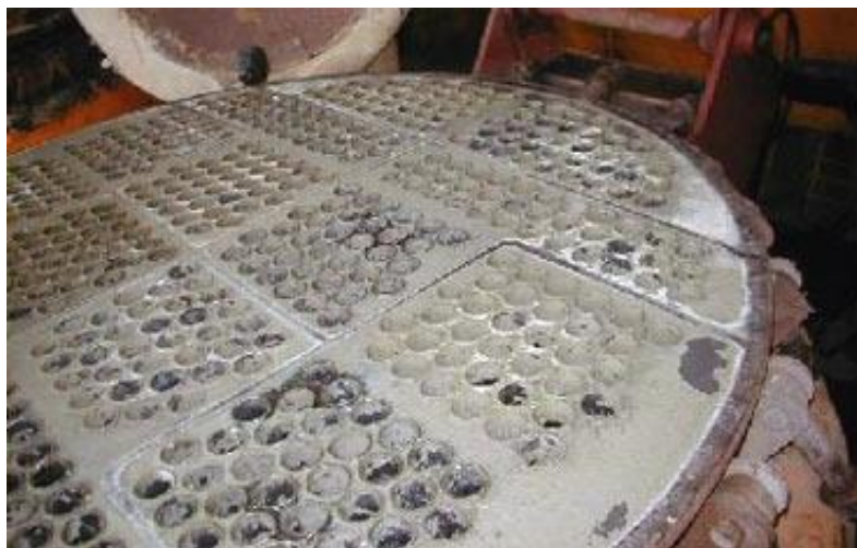
Выпарная установка со снятой верхней крышкой перед очисткой. В трубном пучке 700 труб длиной по 4 метра
