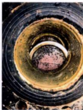
Після роботи системи Гідрофлоу 17.04.18 накип відсутня, слизь не виявлена
