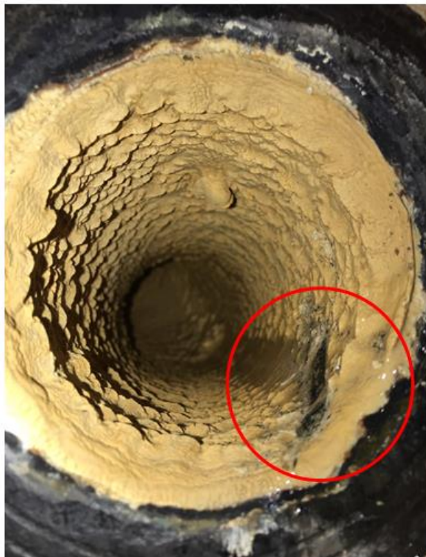
До встановлення системи Гідрофлоу 16.01.2018
