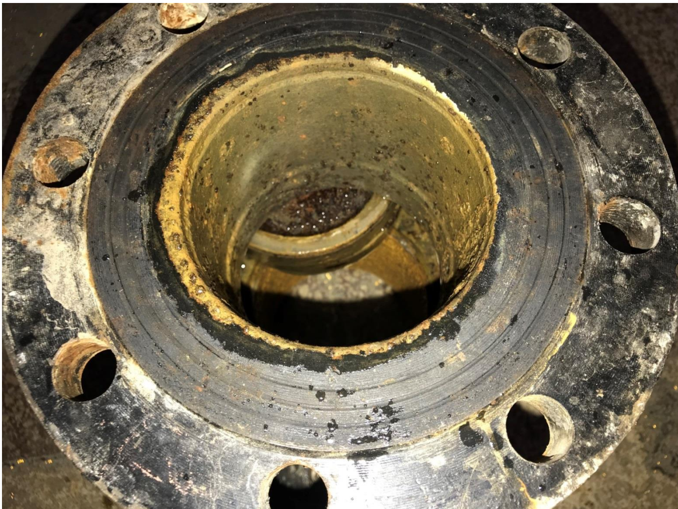
Після роботи системи Гідрофлоу 17.04.18 накип відсутня, слиз не виявлена
