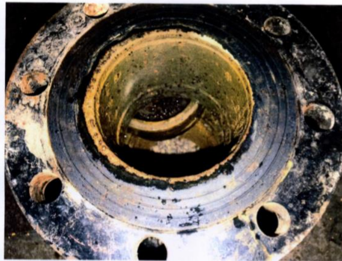
Засувка після роботи системи Гідрофлоу 17.04.18, накип відсутня, слизь не виявлена
