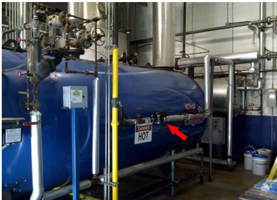
На питательный трубопровод котла смонтировано противонакипное устройство Гидрофлоу С-60
