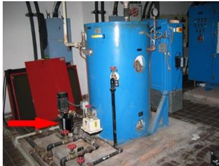
Гидрофлоу серии S установлено на питательный трубопровод котла
