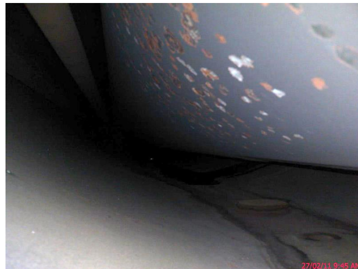
С Гидрофлоу на внутренних поверхностях котла нет следов накипи.
