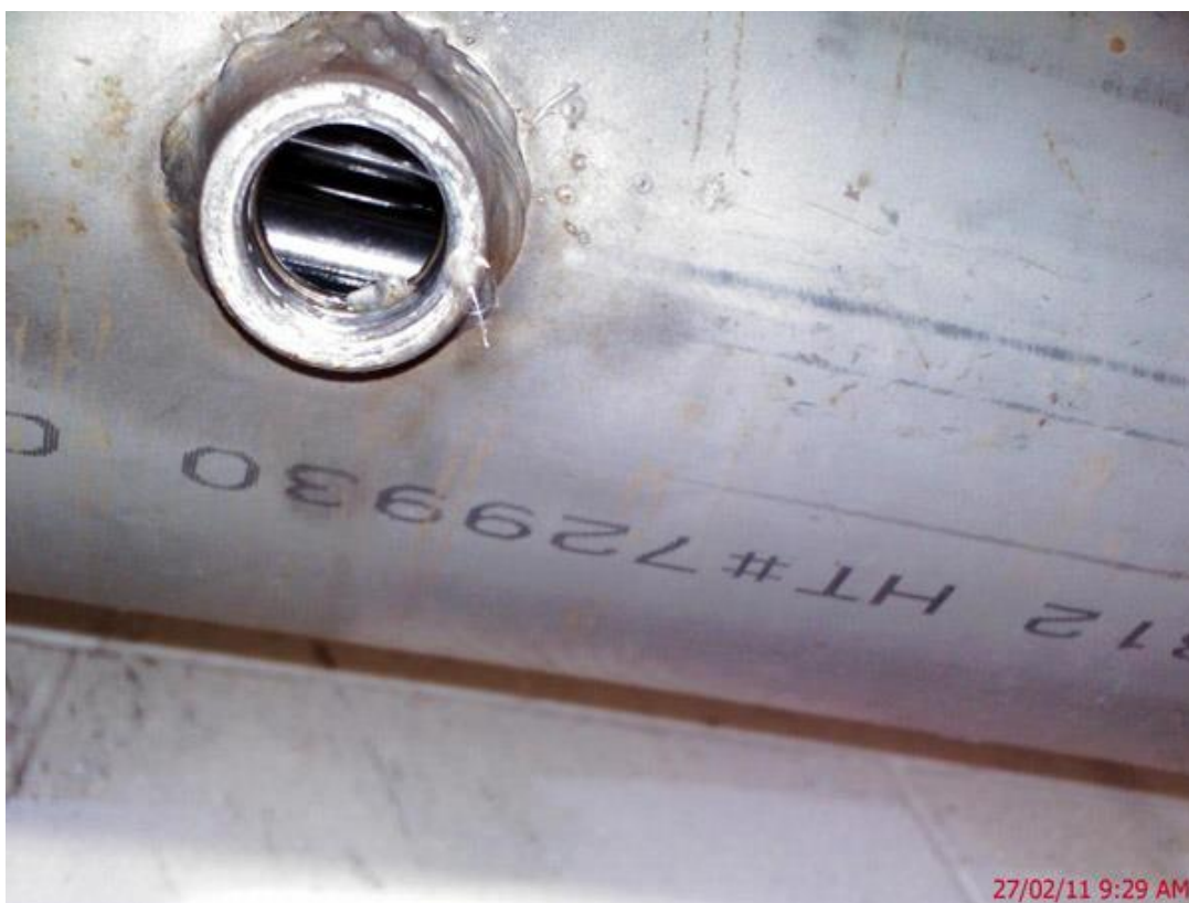
Заглушка снята, видны блестящие поверхности труб теплообменника. Следов накипи нет.
