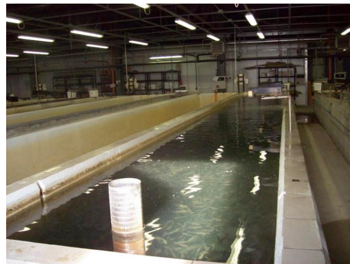
Бассейны главного зала рыбной фермы.
