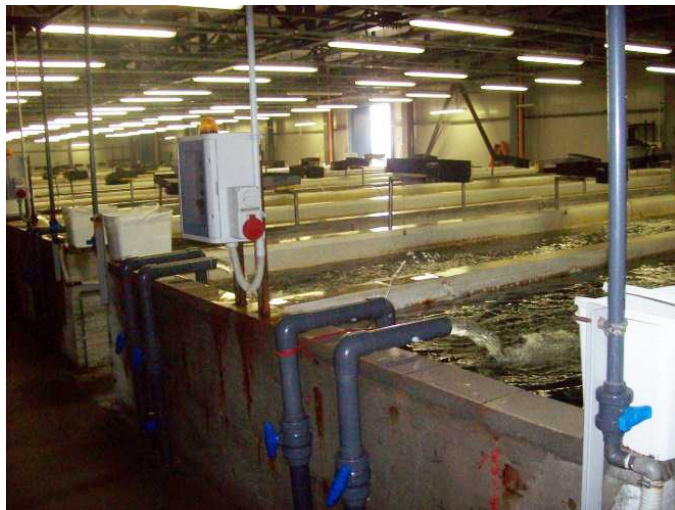
Бассейны главного зала рыбной фермы.
