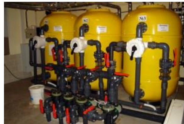
Песочные фильтры с многослойной загрузкой в системе водоподготовки бассейна
