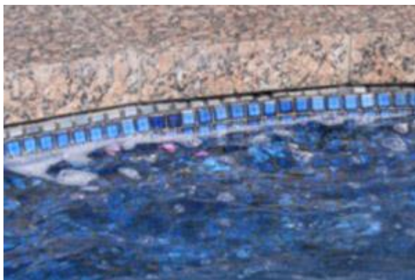
Гранит спустя два месяца после установки Акваклер. Пятна отсутствуют.
